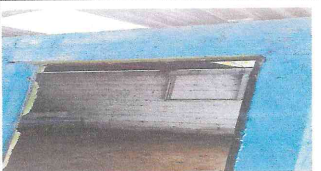
Foto 4: Cocina en mal estado
