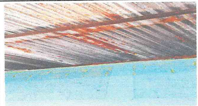
Foto 2: Costaneras podridas por el oxido
