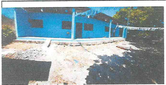
Foto 3: Socavamiento de corredor y patio
